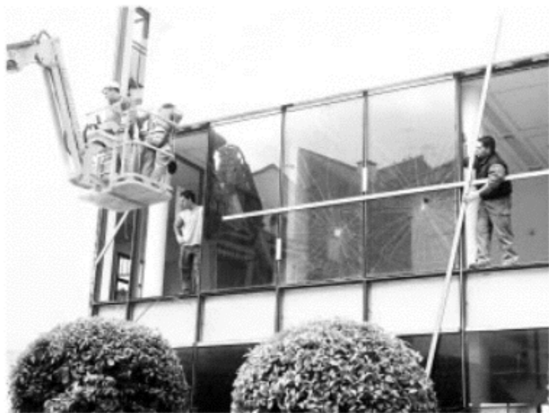
Operarios trabajan desde el lunes en el desmontaje de la Casa de Cristal
