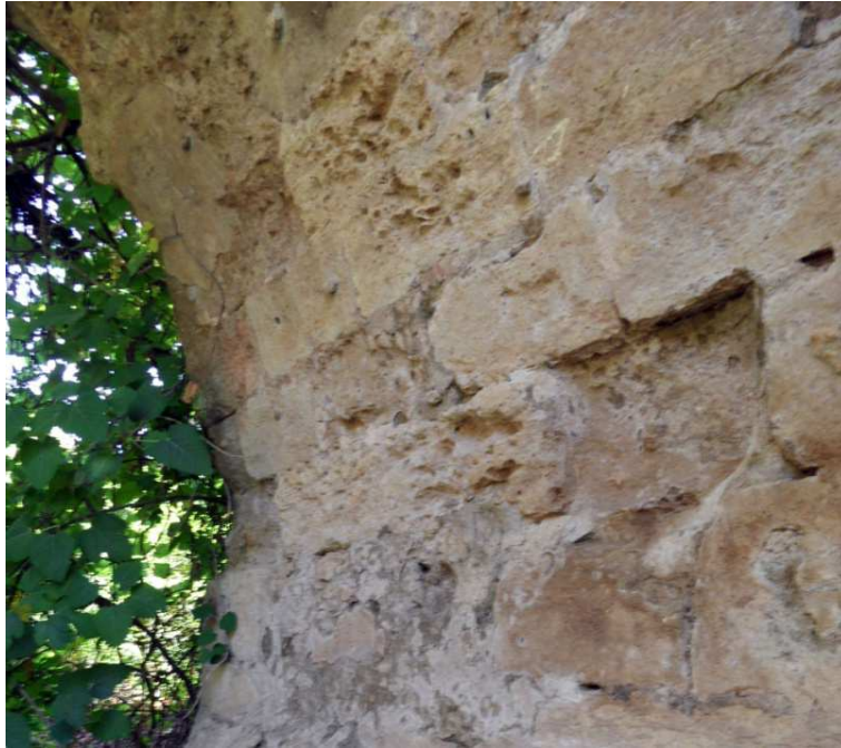
Fig. 124 Erosión y alveolización en bóveda
