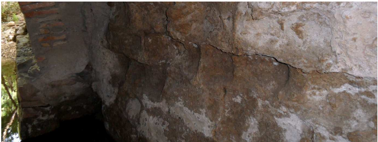
Fig. 103 Erosión de los sillares de la bóveda.
