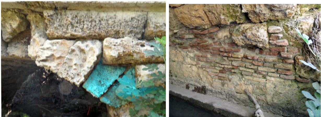
Fig. 43 Dovelas debilitadas por el entallado. Fig. 44 Sustituciones con ladrillos y posible imposta en el arranque.
