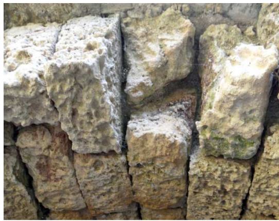
Fig. 55 Erosión y alveolización en sillares.
