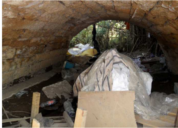
Fig. 53 Suciedad bajo las bóvedas.
