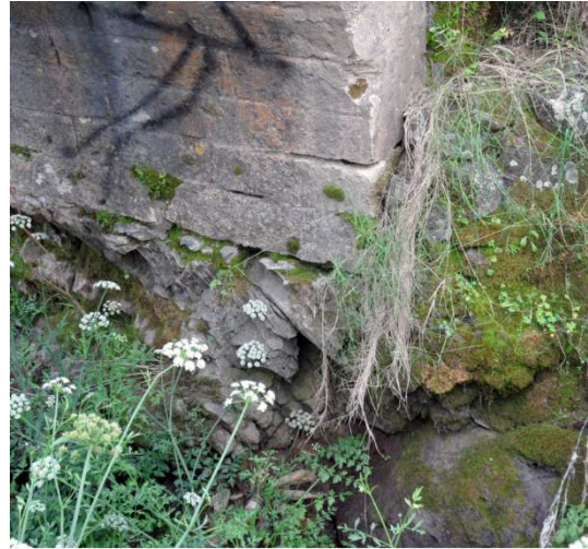
Fig. 77 Socavación en apoyo.
