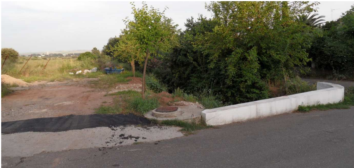
Fig. 61 Situación del arroyo a su paso por la calle Esquivales.
