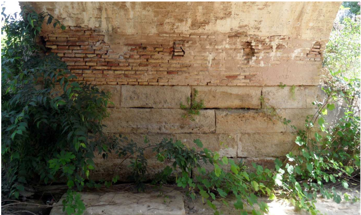
Fig. 91 Mechinales en bóvedas de ladrillo. Zampeado de piedra sobresaliendo de la solera de hormigón.
