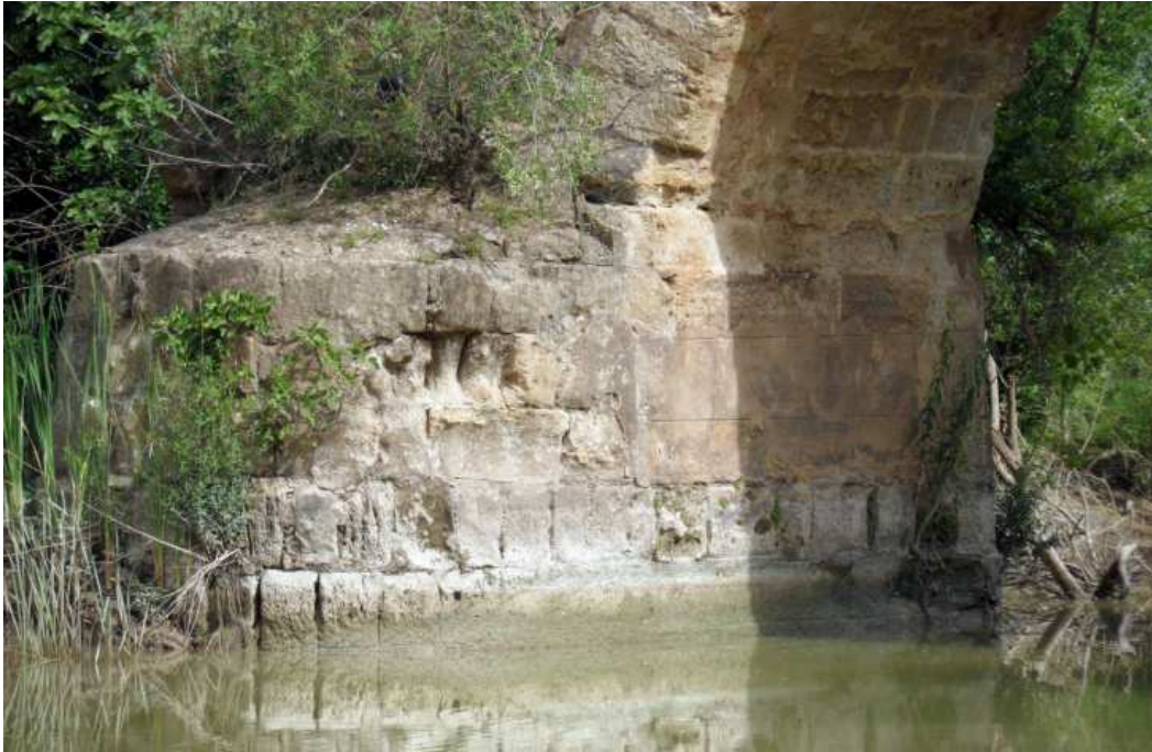
Fig. 122 Erosión en pilas y bóvedas.
