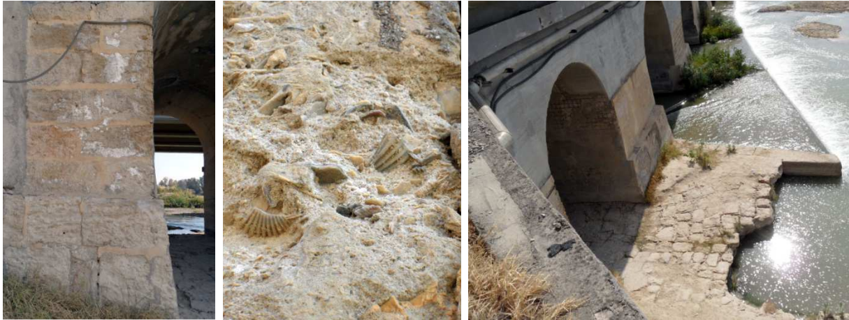
Fig. 136, 137 y 138 Estribo derecho aguas abajo. Detalle de bioclastos en sillares. Zampeado bajo bóveda 7.
