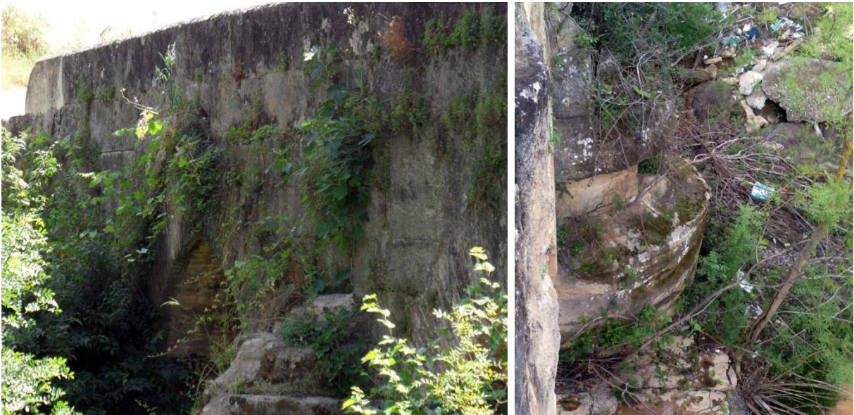
Fig. 93 y 94 Vegetación en boquillas de bóvedas, tímpanos, tajamares y espolones.
