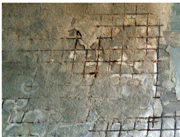
Fig. 140 Oxidación del mallazo.
