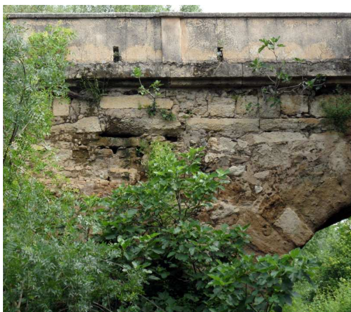
Fig. 116 Posible aliviadero cegado entre vanos 2-3.
