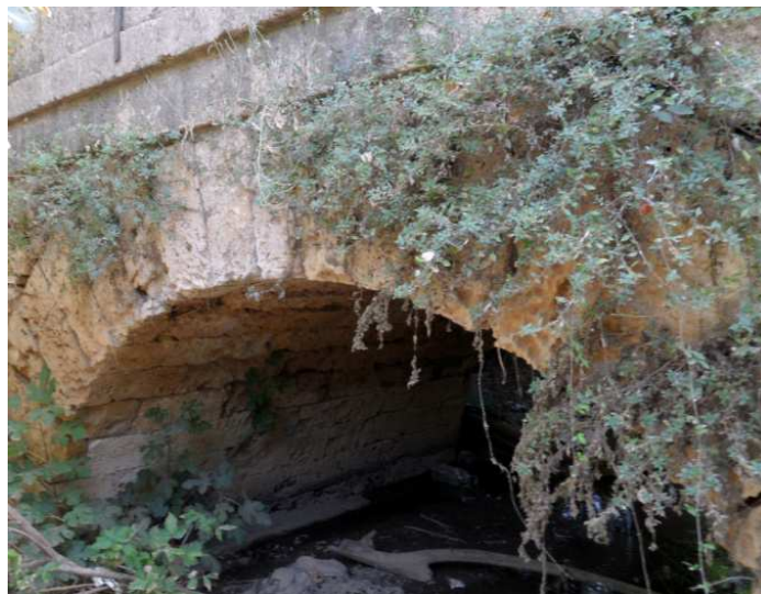
Fig. 48 Vegetación en juntas de sillares.
